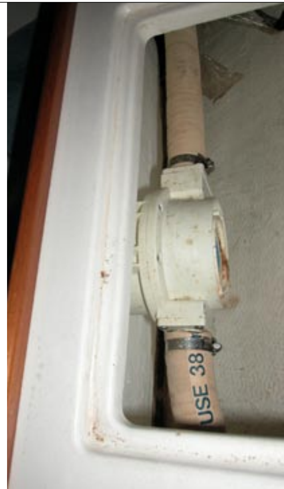
PÅ EN NIMBUS 28 DC -90 sitter den här pumpen för toalettavfallet monterad i styrbords salongsstuv. Den läcker dessutom. Plasttanken ligger under salongsdurken. Odören är påtaglig.
